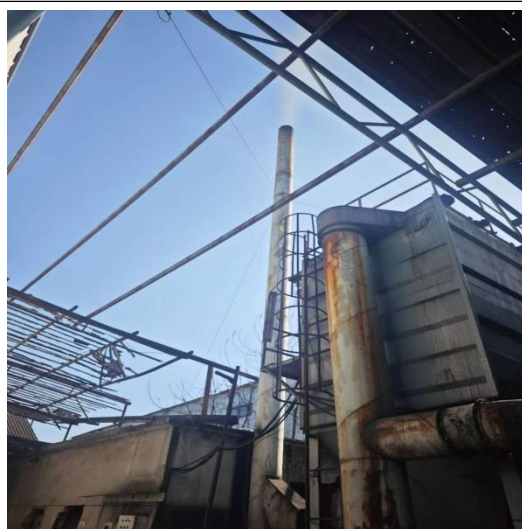
生物质锅炉废气排放口
