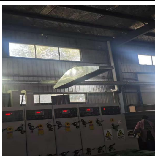
印刷废气收集系统
